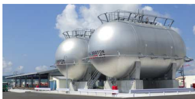
LPガスプラント設備
