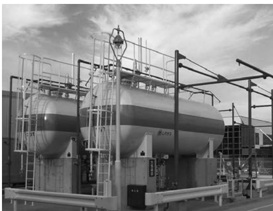
LPガスプラント
