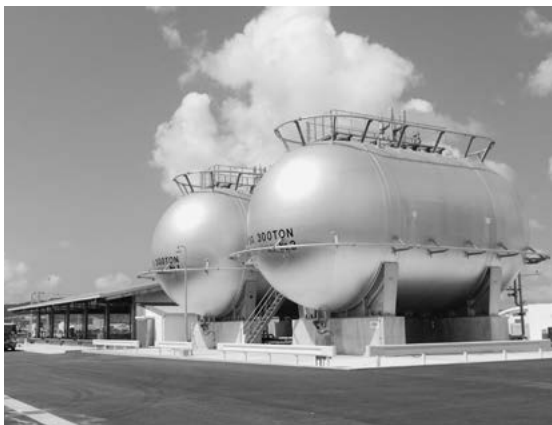
LPガスプラント
