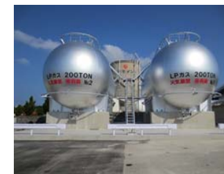
LPガスストレージタンク
