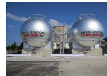
LPガスストレージタンク
