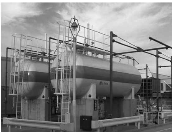
LPガスプラント
