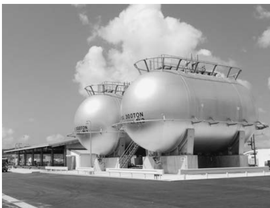
LPガスプラント
